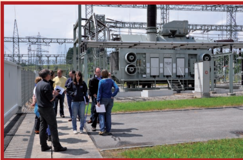
Visiting a distribution station Besuch einer Umspannanlage (Foto: Johann Schreiner)
